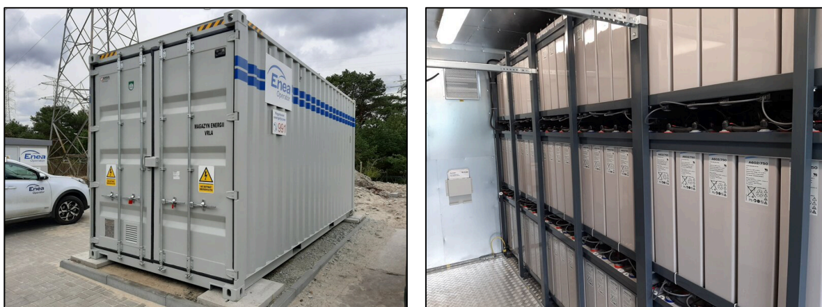
Rycina 17 Przykładowy magazyn energii, po lewej wygląd z zewnątrz, a po prawej wewnątrz (źródło: ENEA S.A. – materiały prasowe)
