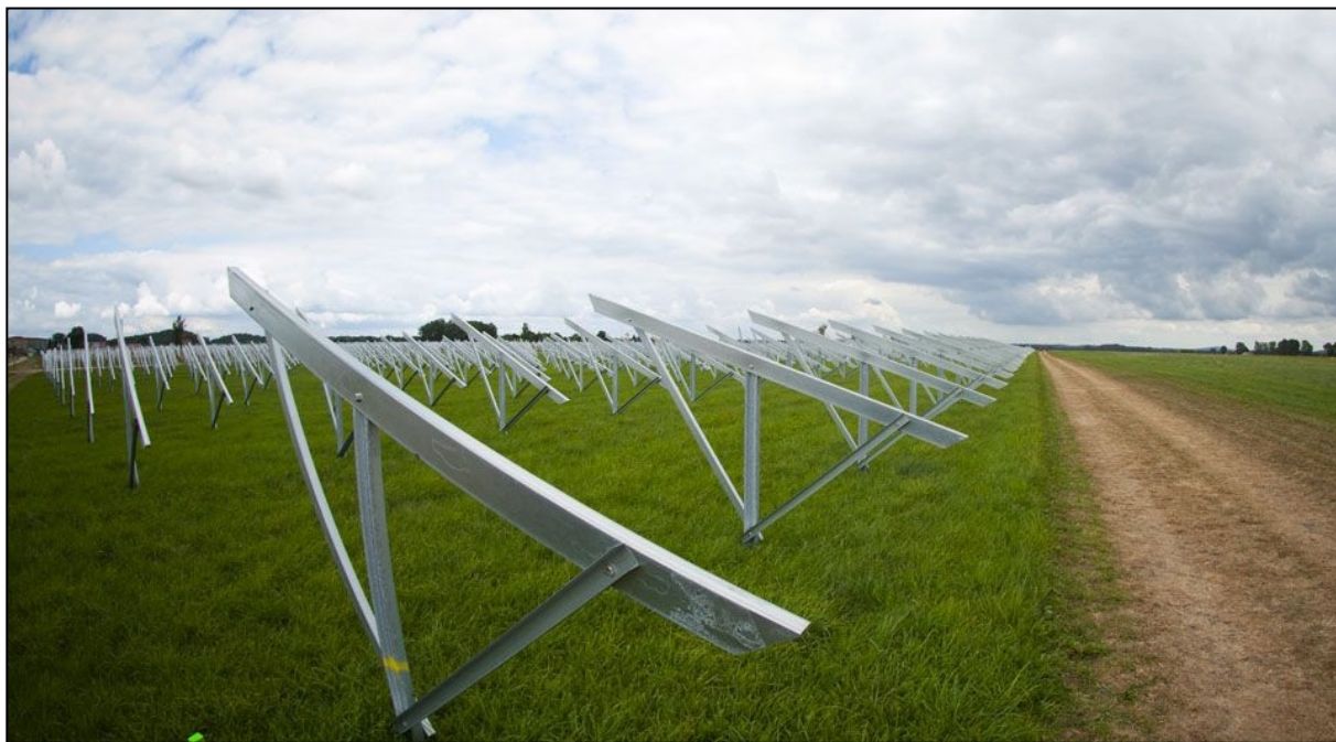
Rycina 11 Stalowe lub aluminiowe konstrukcje pod panele fotowoltaiczne
