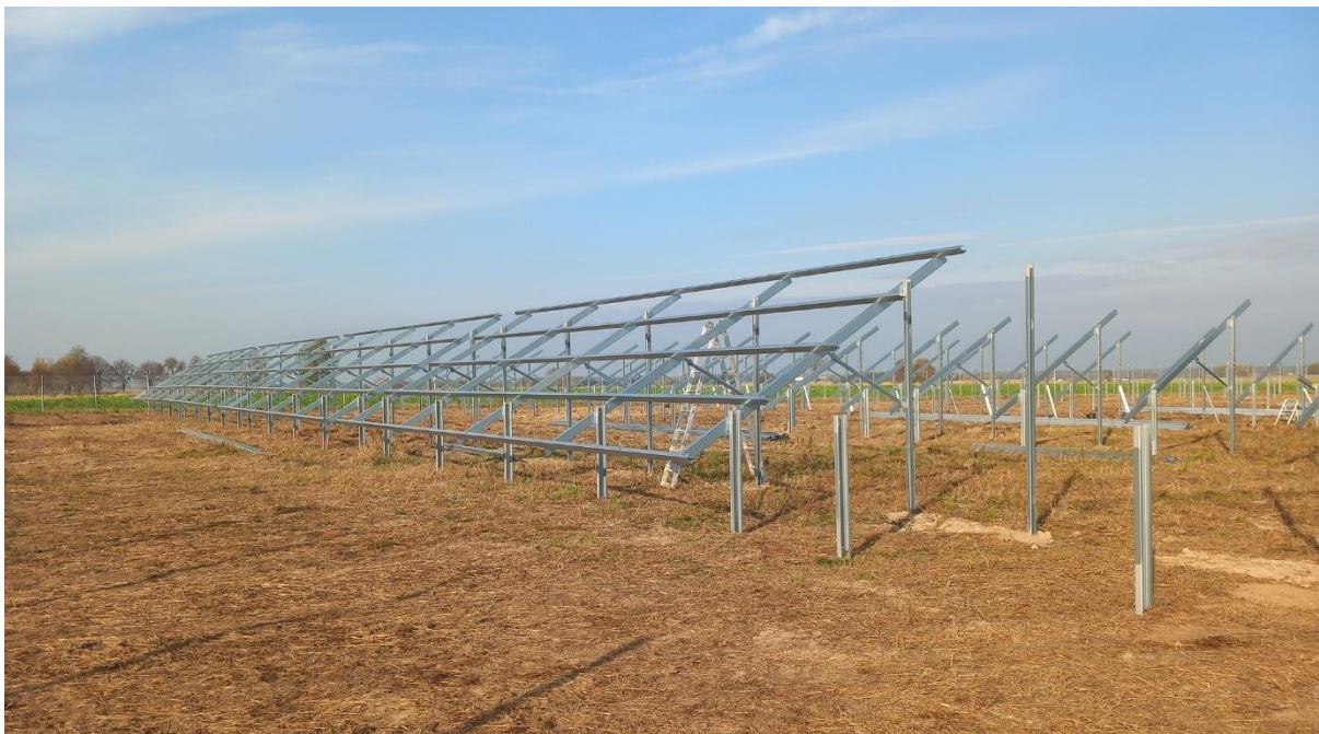
Fot. 3-1: Metalowe stelaże pod moduły fotowoltaiczne (fot. A. Kozłowska 2022 r.)
