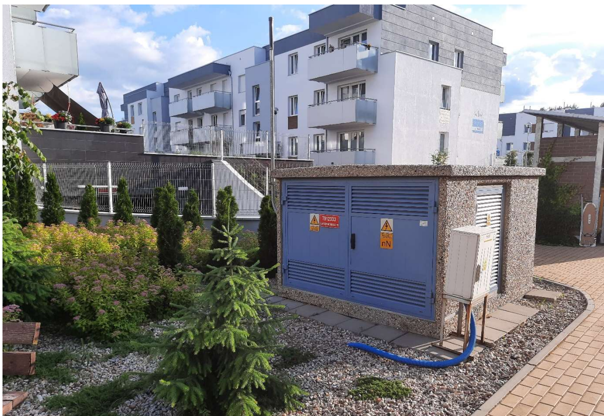
Rycina 10. Stacje transformatorowe w otoczeniu zabudowy mieszkaniowej.
