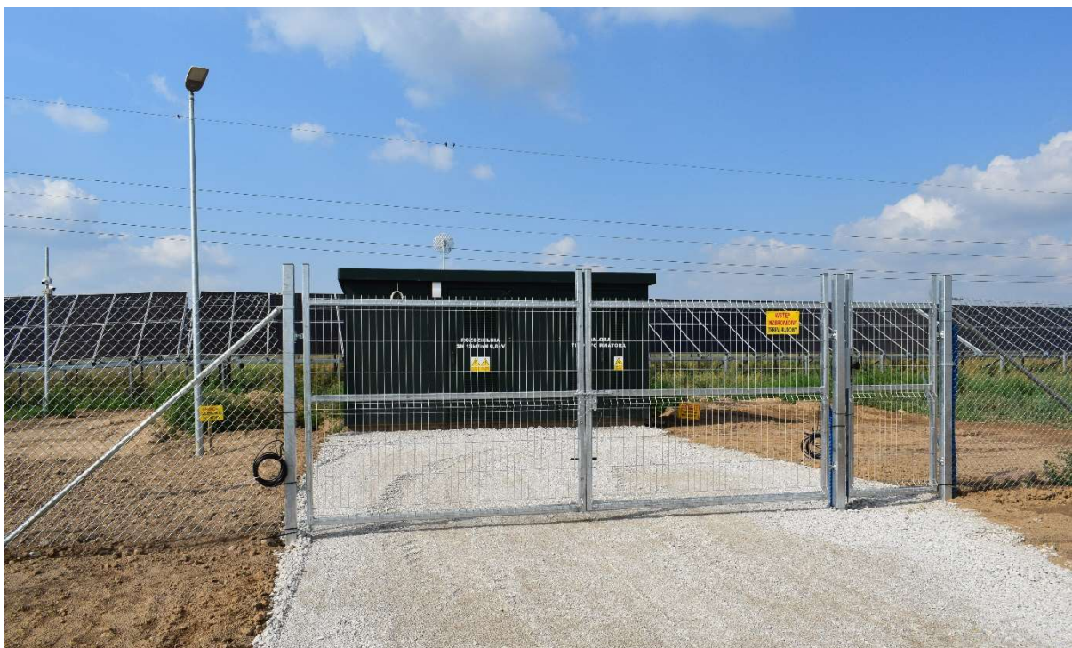
Rycina 7. Przykładowa stacja transformatorowa.
