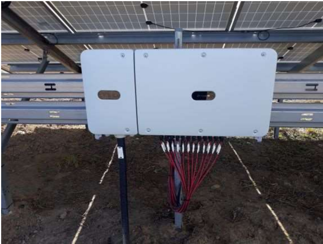
Rycina 6. Przykładowy inwerter farmy fotowoltaicznej.
