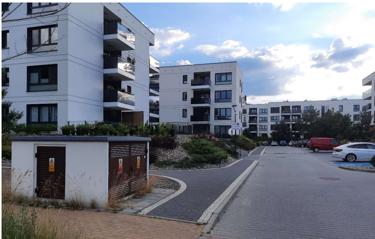
Rycina 9. Standardowa stacja kontenerowa w otoczeniu zabudowy.
