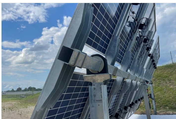
Rys. 11. Konstrukcja wsporcza z zainstalowanym systemem nadążnym (źródło: https://budujemydom.pl/instalacje/kolektory-sloneczne-i-fotowoltaika/a/99204-tracker-aktywnie-w-kierunku-sloneca ).
