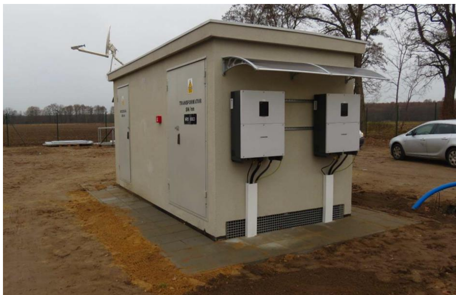
Ryc. 20 Przykładowa stacja transformatorowa z zainstalowanymi falownikami. Źródło: materiały własne
