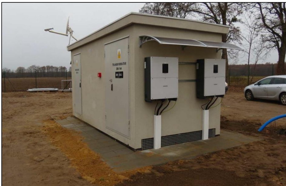
Ryc. 17 Przykładowa stacja transformatorowa. Źródło: materiały własne.
