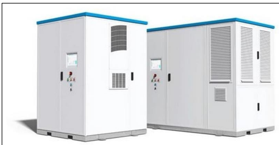
Ryc. 18 Przykładowy magazyn energii.
