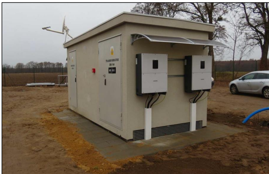
Ryc. 17 Przykładowa stacja transformatorowa. Źródło: materiały własne.
